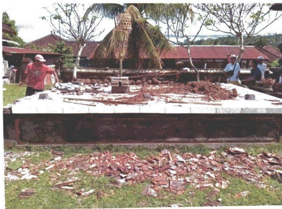
FOTO SEBELUM DIREHABILITASI BALAI PIASAN PURA PEMAKSAN
